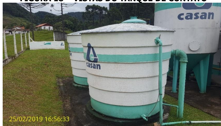
FIGURA 18 – VISTAS DO TANQUE DE CONTATO
